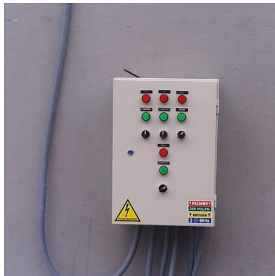
FOTO No.3 Tablero eléctrico
