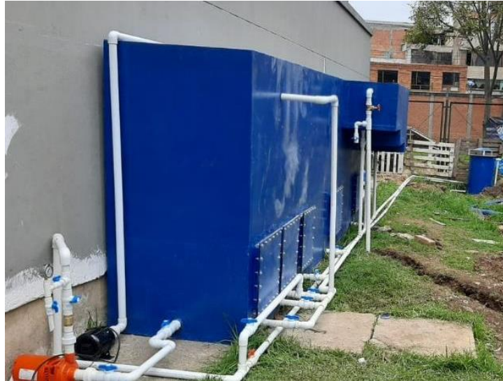
FOTO No.1 Planta de Tratamiento de Aguas Residuales
